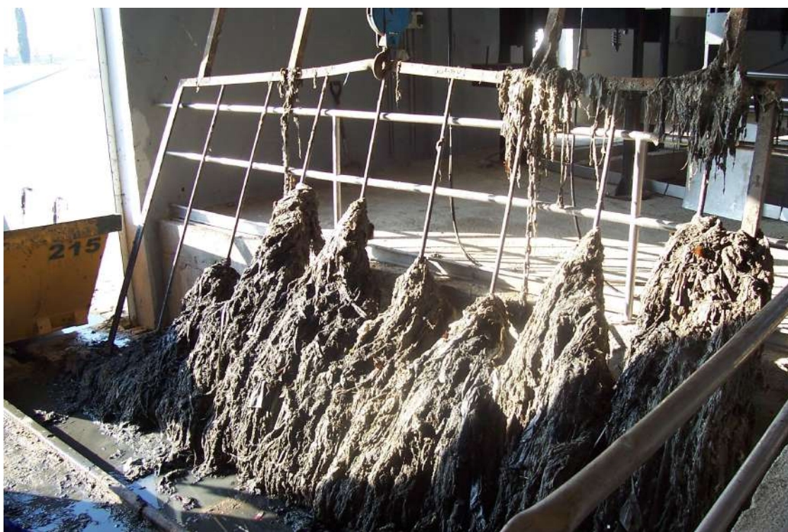
Cientos de toallitas apelmazadas en uno de los filtros de la depuradora de Jerez.
